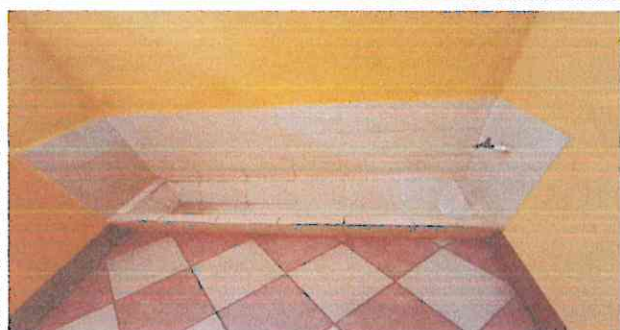
Foto 7: Sustrución de Azulejo en Sanitarios lo que estan tienen mucho sarro acumulado y no sale al lavarlos
