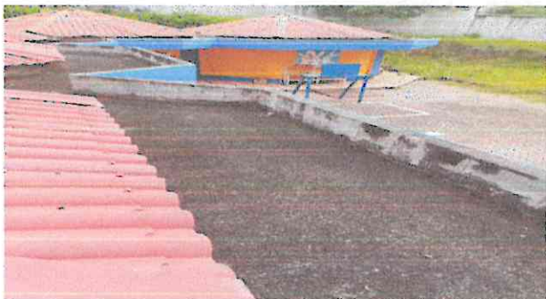
Foto 1: Impermeabilización de losa en techo de aulas, baños y dirección porque se filtra el agua por la terraza
