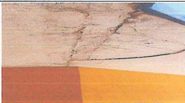
Foto 2: Grietas ocasionadas por las filtraciones de la terraza
