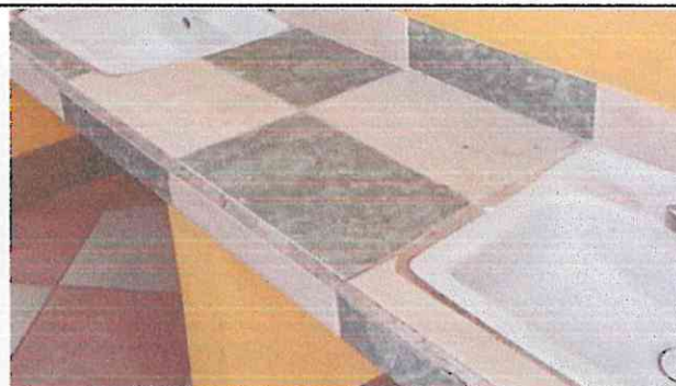
Foto 8: Sustrución de azulejo en sanitarios porque estan rajados
