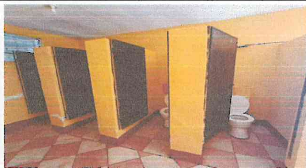
Foto 4: Sustitución de servicios Sanitarios y accesorios se encuentran en mal estado ya no sirven los accesorios
